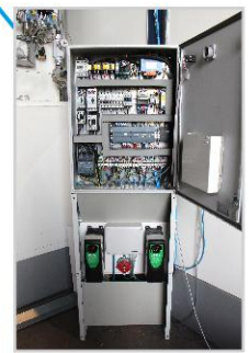
Stromverteilung - SPS gesteuert, mit Stromrichtergeräte.
