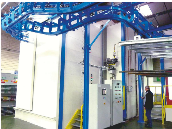
Polymérisation poudre - portes blindées* 2
