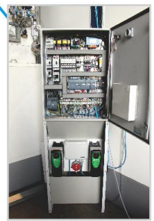
Armoire de puissance gérée par automate avec variateurs de vitesse
