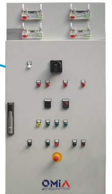
Armoire de puissance électrique extérieure et commande depuis l'intérieur du poste.
